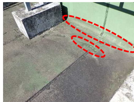
防水シートのふくれ
