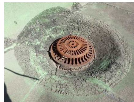
ドレーン部防水の劣化
