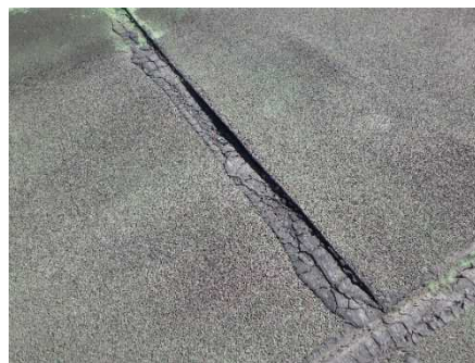
シーリングの劣化
