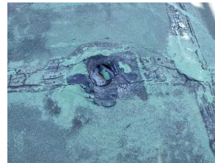
防水シートの破損
